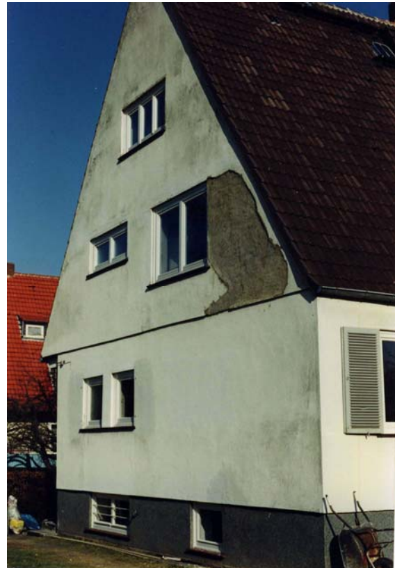
Beispiel: Schaden Westfassade Rie 37 1994
